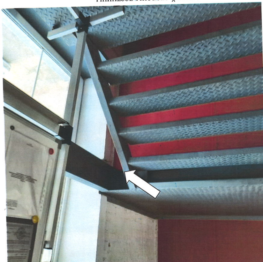
Фото № 7. Отсутствует поручень с одной стороны лестницы
