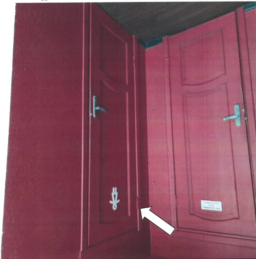
Фото № 12. Дверные проемы в санузлах контрастно не маркированы. Недостаточно информирующих обозначений
