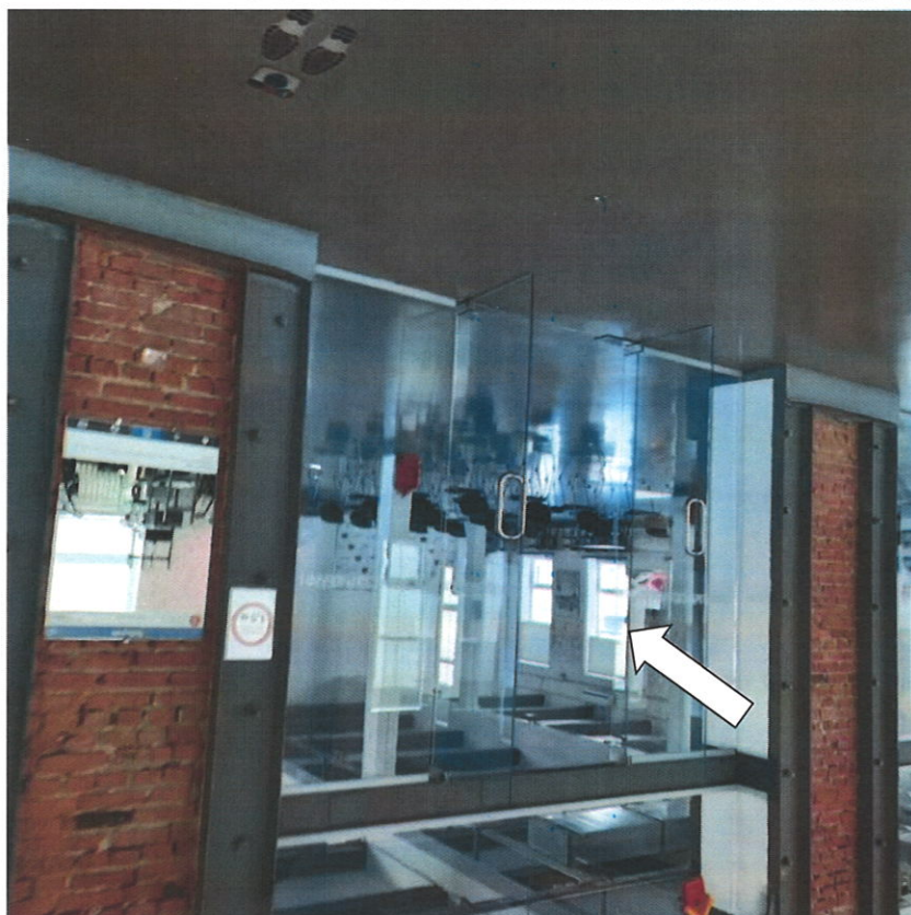
Фото № 10. Дверные проемы в зале и стеклянные смотровые панели контрастно не маркированы. Нет информирующих обозначений
