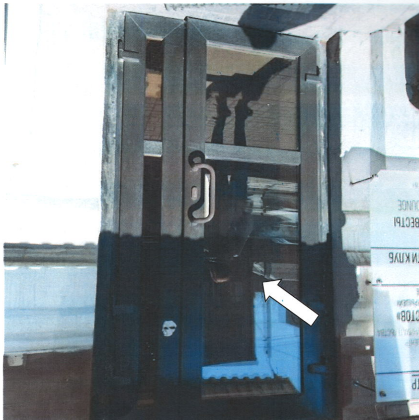
Фото № 2. Контрастно не маркированы прозрачные смотровые панели на входной двери в здание
