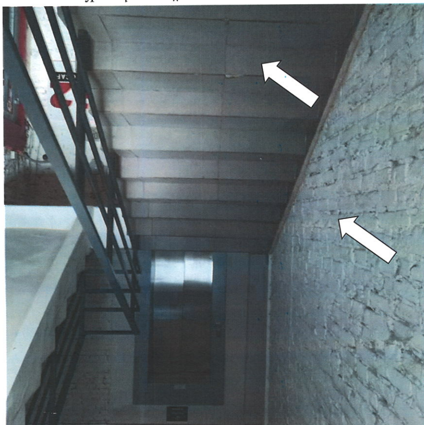
Фото № 5. Нет второго поручня на лестнице, ведущей к лифту. Краевые ступени контрастно не маркированы
