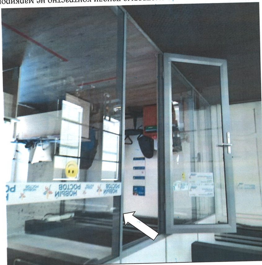
Фото № 8. Дверные проемы и стеклянные смотровые панели контрастно не маркированы
