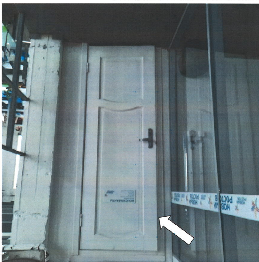
Фото № 9. Дверные проемы контрастно не маркированы
